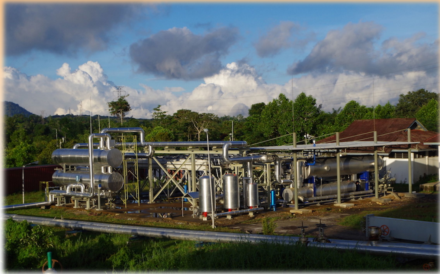
Бинарна геотермална електроцентрала Лахендонг, Индонезия
